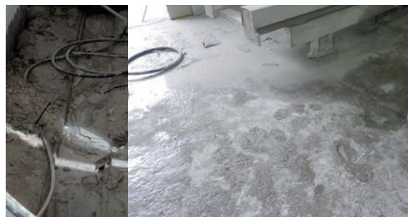
Figs. Acumulación de polvo consecuencia de drenaje inadecuado y malas prácticas en limpieza. Esto puede anular la eficacia de los mejores métodos de prevención que tenga instalada la empresa.
