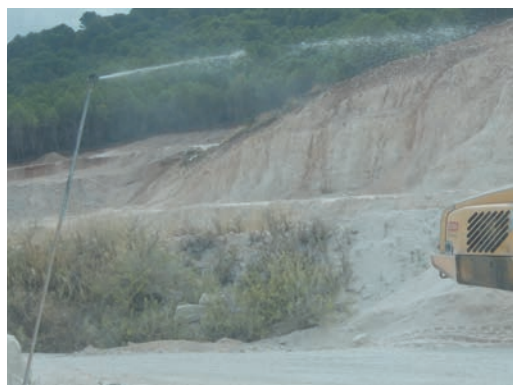
Fig. Es fundamental el riego de pistas para evitar la puesta en suspensión de polvo.
