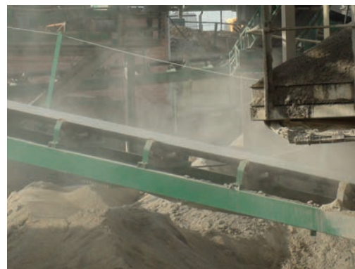
Fig. Cinta sin capotaje, ni humectación del material, y acumulación de polvo por falta de plan de limpieza.
