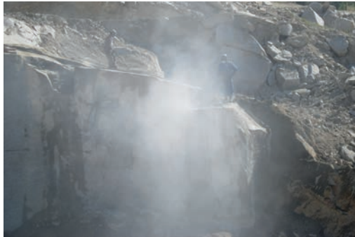
Fig. Perforación sin medidas preventivas. Riesgo generado a los trabajadores.
