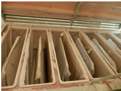
Fig. Filtradores saturados debido a un mal mantenimiento, que pueden llegar a inutilizar el sistema o eliminar su eficacia. Esto, tanto en el caso de filtros para decantar polvo cuando se extrae aire mediante captaciones, como filtración de aire que se introduce en la nave. En todos los casos es fundamental contar con un plan de mantenimiento específico rigurosamente implantado.
