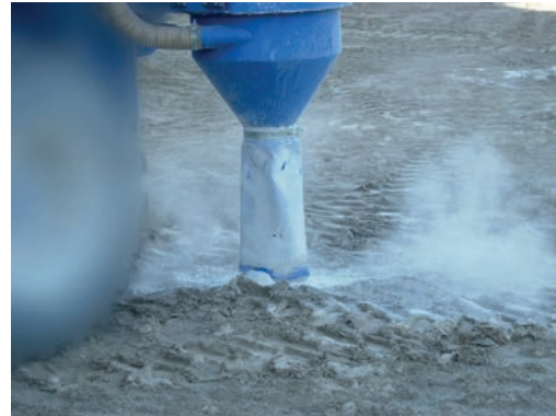
Fig. Captación de polvo de perforadora sin almacenamiento (y retirada) del residuo.
